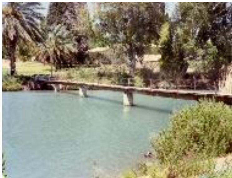
איור 12: גשר המעברה המערבי. עדין עם מעקה הכבלים הישן. (צילום בארכיון ניר דוד).
